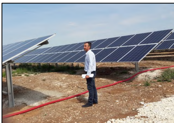
Structures en 2V (2 panneaux en portait)
